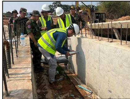
ត្រួតពិនិត្យគុណភាពបេតុងនៅការដ្ឋាន ដោយ ប្រើឧបករណ៍ Schmidt Hammer
